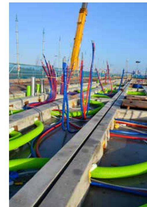
Het Air Excellent luchtverdeelstelsysteem verwerkt in de kanaalbreedplaatvloer.
